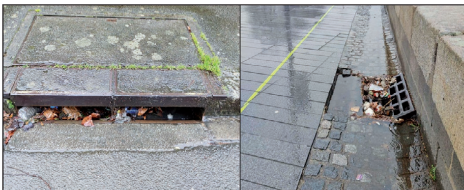
Figure 6. Exemples d'accumulation de déchets au niveau d'avaloirs à paroi siphonoïde (à gauche) ou à grille (à droite)
