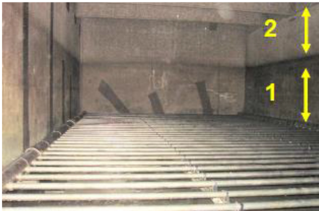
Fig. 4. État du béton sous le plancher du biofiltre de la station Seine Centre (zone 1 : sous le massif de billes ; zone 2 : massif de billes) [7].
