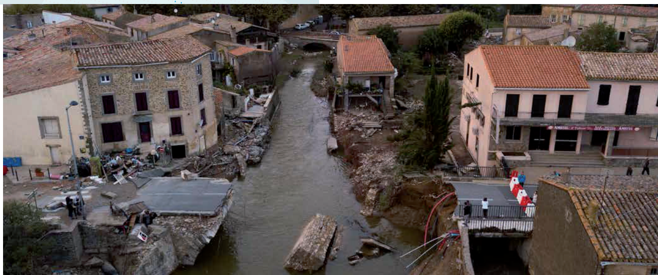
Les restes du pont de Villegailhenc emporté par l'inondation Photo Sébastien Gominet/IRMA
