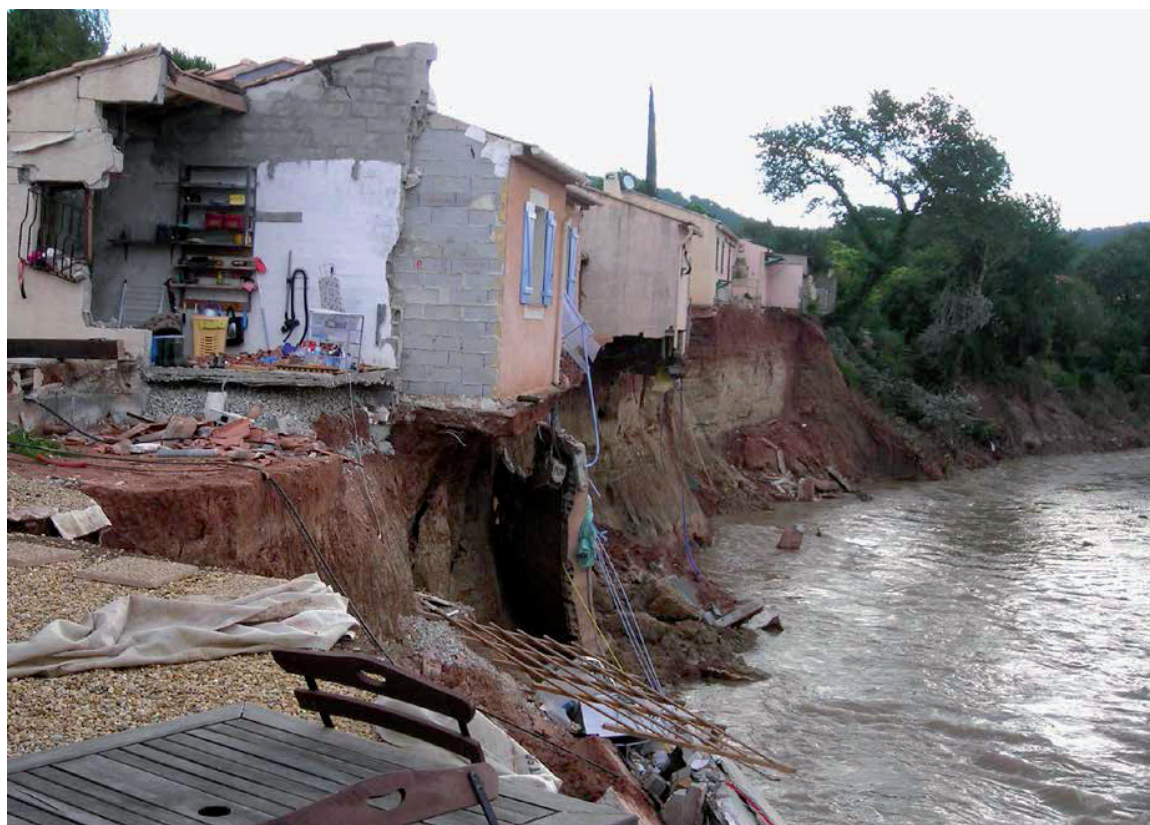
Érosion des berges de la Nartuby (commune de La Motte, 83) par l'énergie du courant Photo DDTM 83.
