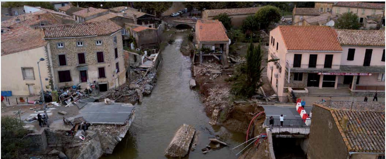
Les restes du pont de Villegailhenc emporté par l'inondation Photo Sébastien Gominet/IRMA
